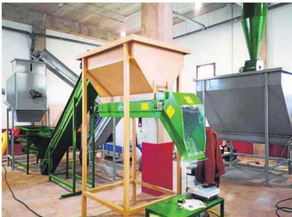
Imagen correspondiente al montaje de los distintos elementos de la planta de biomasa de Artenara. c7
